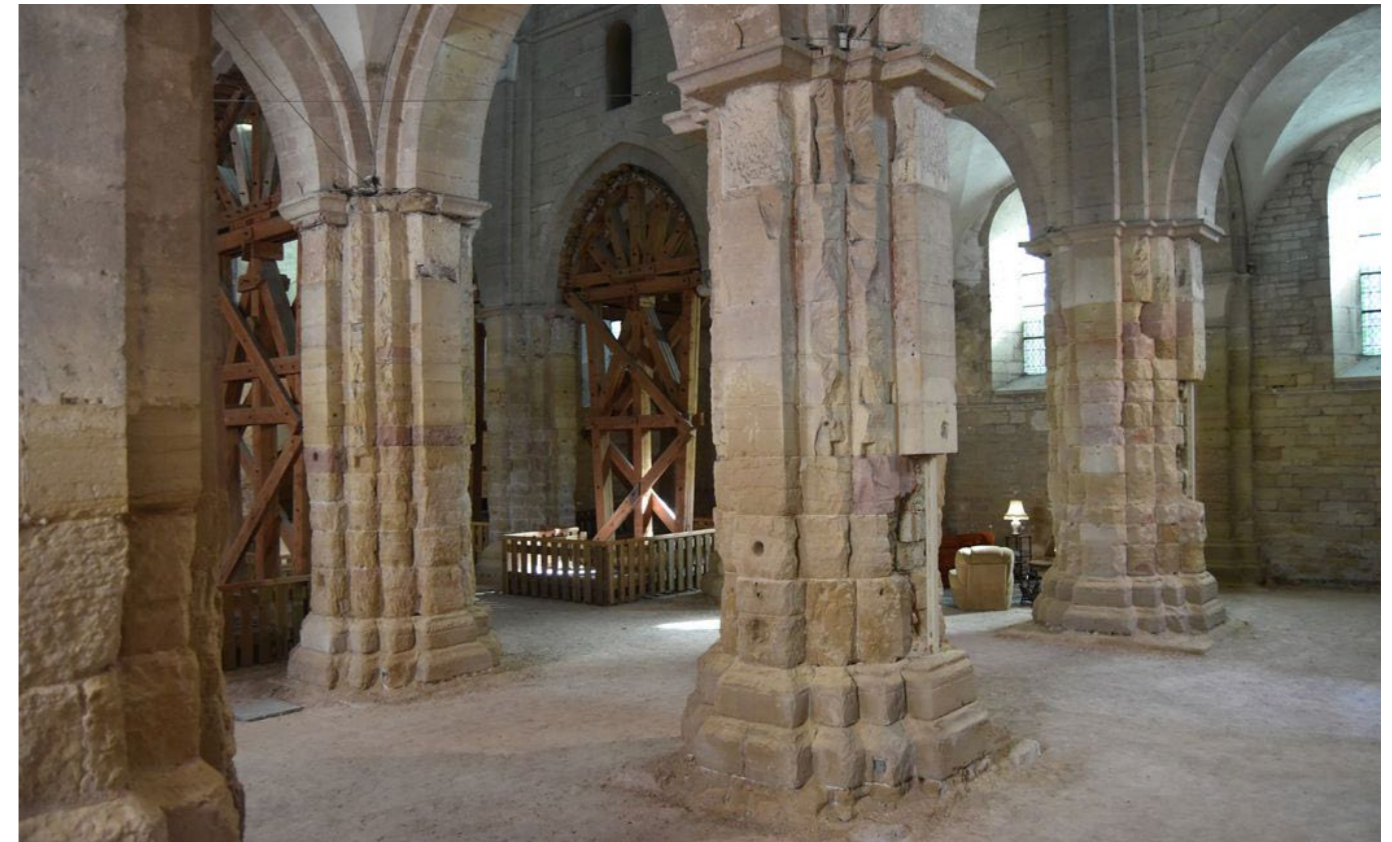
Vue des piles dégradées par les remontées salines et des systèmes d'étaieement et de frettage, état 2021. Coll. Médiathèque de l'architecture et du patrimoine
