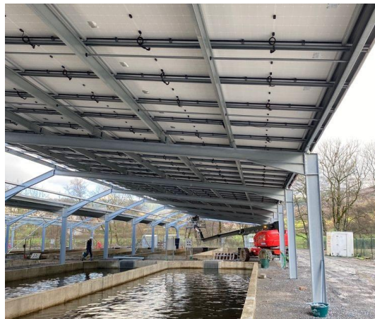
Château-Chinon (Nièvre) – LPA du Morvan : ombrière photovoltaïque sur la pisciculture de Corancy – Coût de l'opération : 2 200 000 € – Réceptionnée en février 2024
